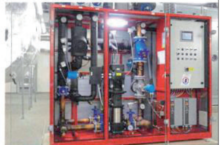
Das Herzstück aller SEW-Anlagen ist die kompakte, aber variable Armaturenbau-Gruppe. Eine Simatic-Steuerung sorgt hier für die richtige Fluidmenge, die Betriebssicherheit und das Monitoring.
