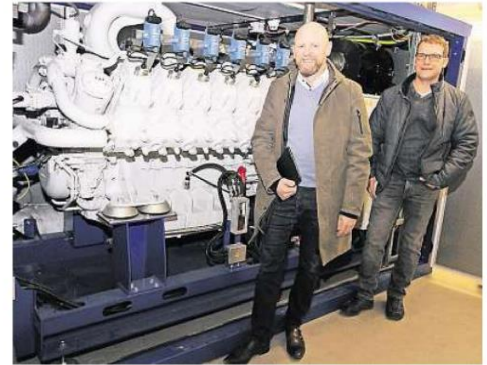
Peter Weidemann (links) und Ralf von der Forst kontrollieren täglich die Versorgungsanlagen der Kliniken Maria Hilf. FOTO: KLINIKEN MARIA HILF
